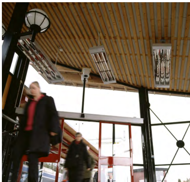
Dworzec kolejowy ogrzewany promiennikami IR pod Sztokholmem. Regulacja za pomocą programatora pozwala zwiększyć ogrzewanie dla oczekujących pasażerów, kiedy jest szczególnie zimno.
