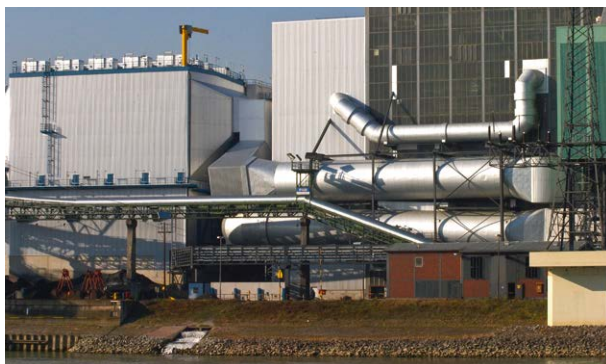
GKM GrossKraftwerk (elektrownia węglowa) Mannheim, Niemcy
