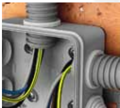
Kwadratowa puszka rozgałęźna z doprowadzonymi elastycznymi przewodami
