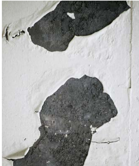
Warstwa uszczelniająca uszkodzona wskutek ciśnienia osmotycznego.
