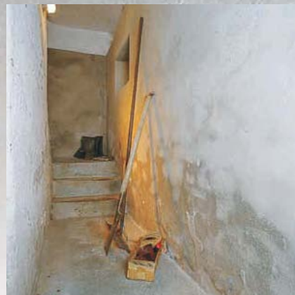
Pomieszczenia piwniczne z widocznymi śladami szkód powstałych pod wpływem wilgoci i soli (przed renowacją)
