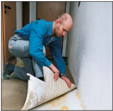
jastrychy magnetyzowe, z asfaltu lanego, z resztkami klejów do wykładzin, PVC
